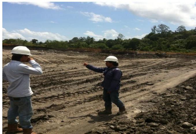
Gambar 6. Kondisi jalan yang tidak memiliki lapisan perkerasan.
